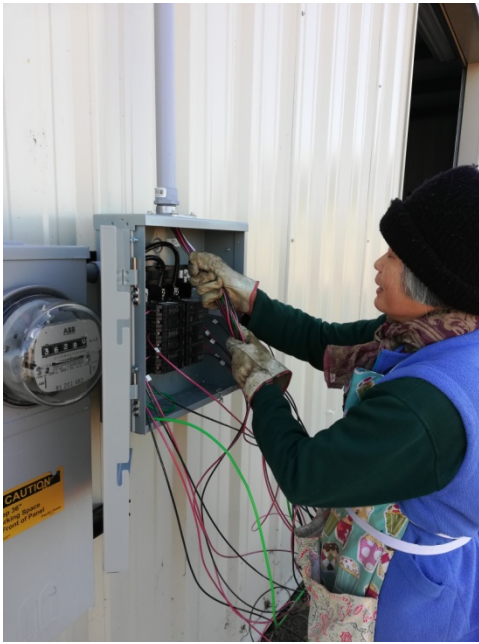
拉接太阳能板的电线
