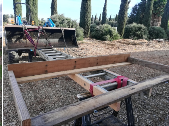
装太阳能板的平台
